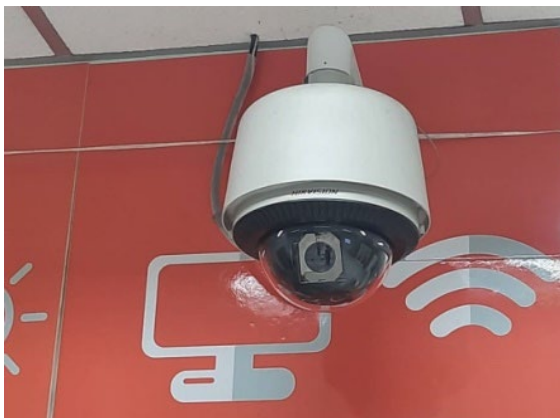
รูปที่ 3.6 กล้องวงจรปิดแบบหมุนปรับมุมและควบคุมได้
